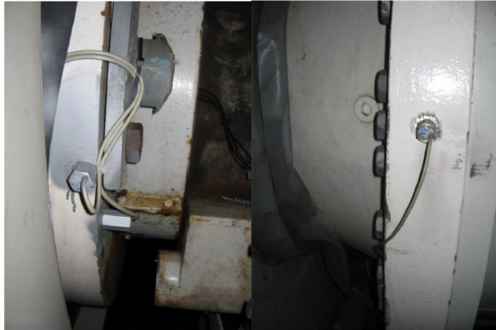
Senzori instalati pe cutia de viteze, respectiv pe rotorul turbinii
